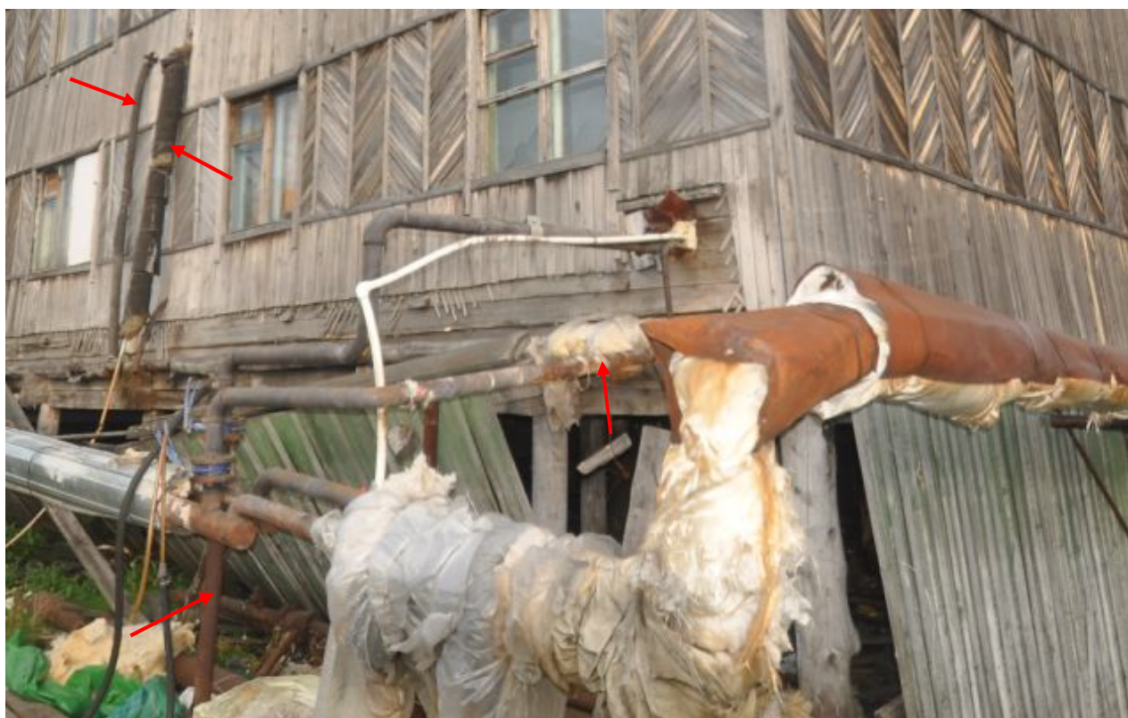
Фото 4. Система центральной канализации отсутствует и не соответствует требованиям действующих норм. Коррозия элементов трубопроводов, разрушение теплоизоляции трубопроводов
