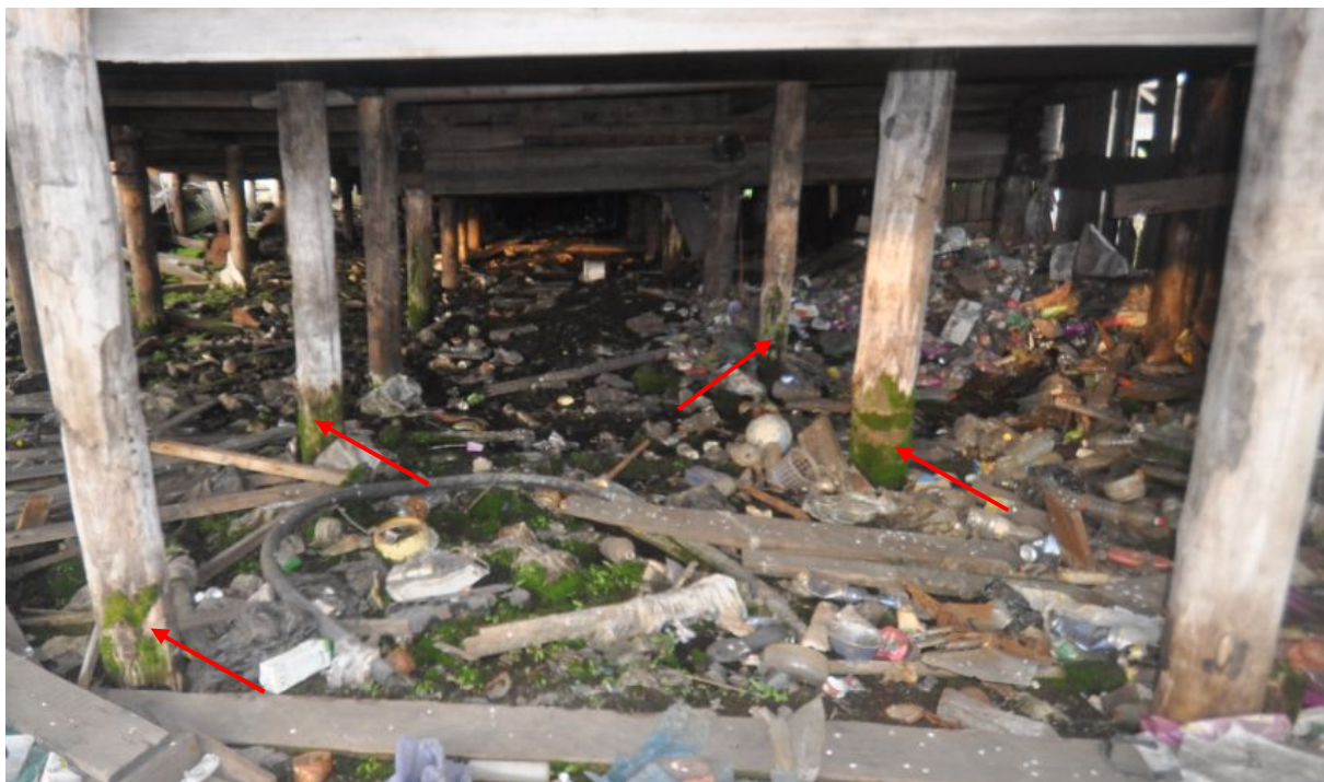
Фото 1. Биологическое повреждение древесины свай в зоне контакта с грунтом.
