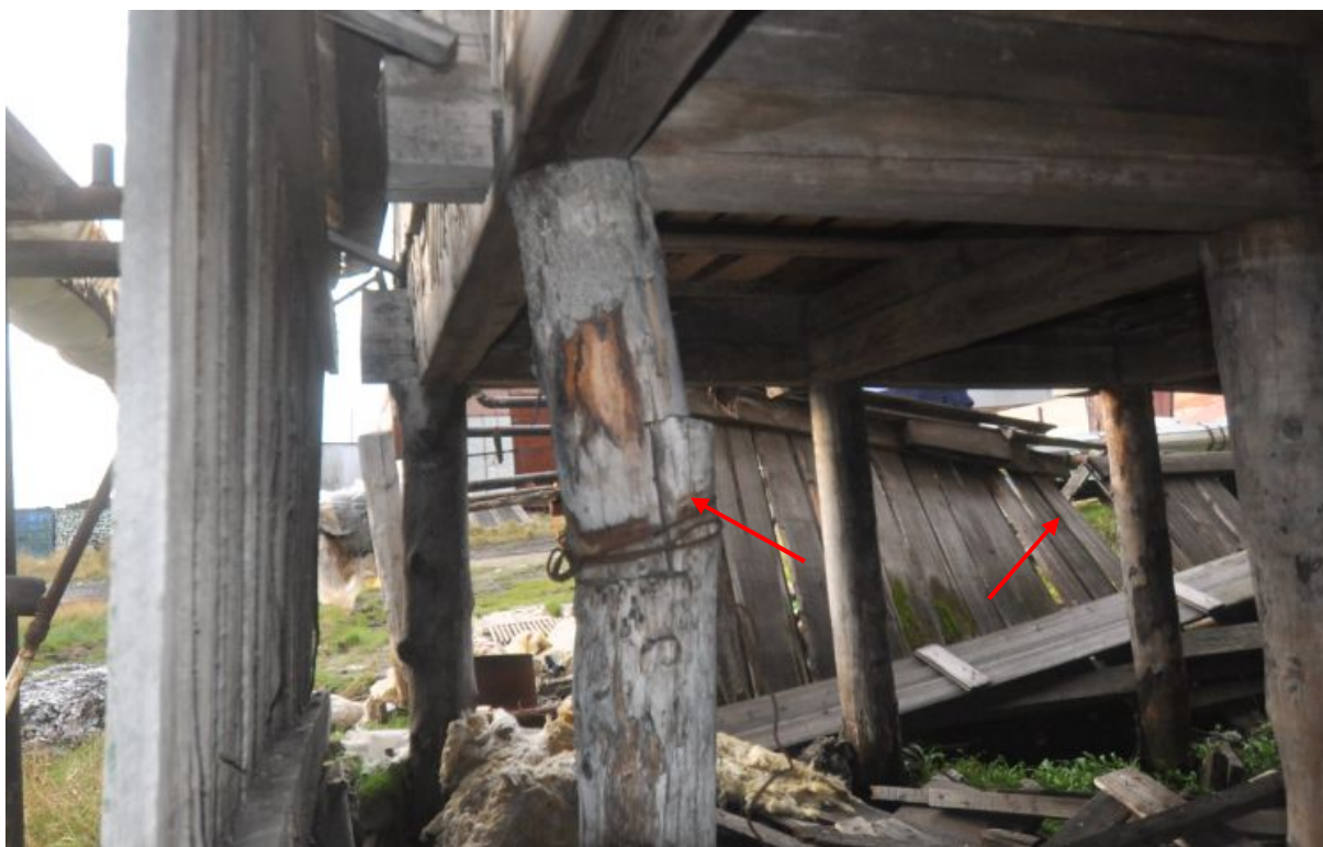
Фото 2. Разрушение деревянных свай. Отсутствие, разрушение деревянной за- бирки технического подполья на локальных участках
